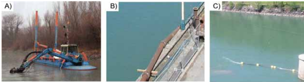
Photographie 4.2 - (A) Petite drague utilisée pour les petites opérations de dragage (entre 1 000 et 2 000 m 3 environ) ; (B) conduite par laquelle le galet aspiré transite à l'aval du barrage et (C) rejet des sédiments à l'aval du barrage (clichés :J.Lejot, 2004)
