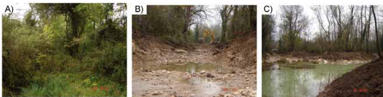
Photographie 4.5 - Lône de Bellegarde A) avant restauration, B) pendant les opérations de curage et C) après les travaux de restauration
