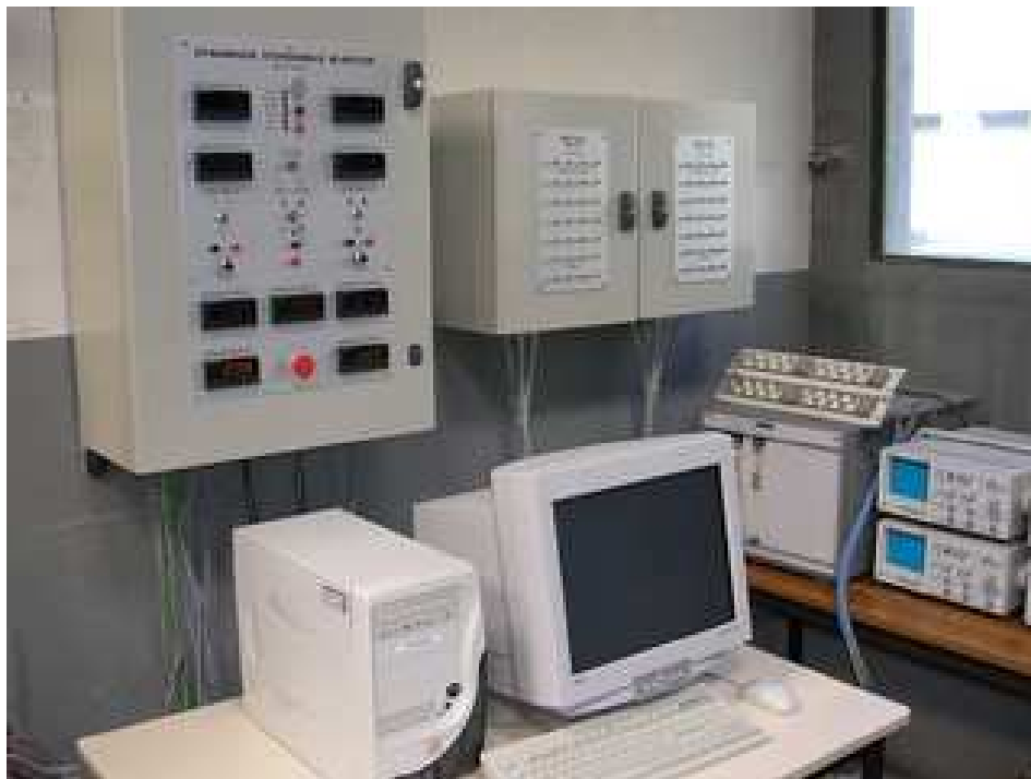
FIG. 6.11 – Salle de contrôle
