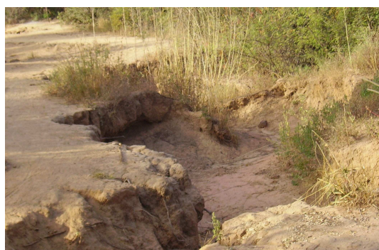
Photo 5.2 : Erosion à la station de Coubéri
