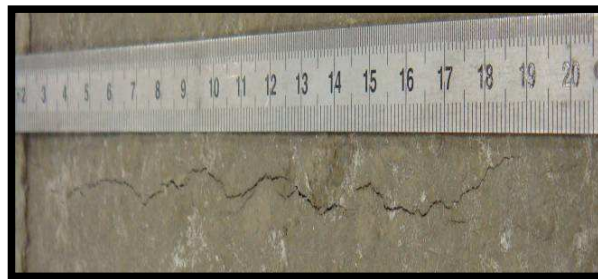
Figure I-48 : Fissure de retrait de plastique.
