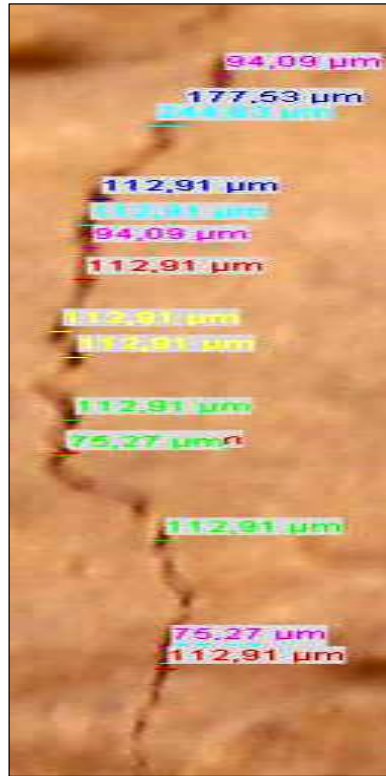
Figure II-58 : Exploitation de la fissure par traitement d'image.
