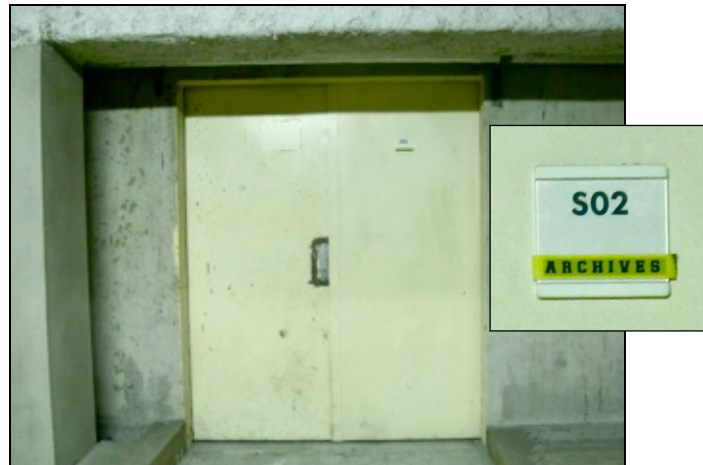
Figure 17 : Le local des « Archives » du département STEP, situé au sous-sol du bâtiment
