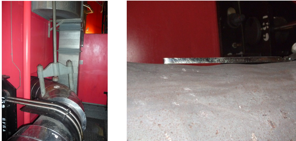
FIGURE 1 – Illustration des dommages engendrés par un coup de bélier sur une tuyauterie du parc de production d'électricité nucléaire d'EDF.
