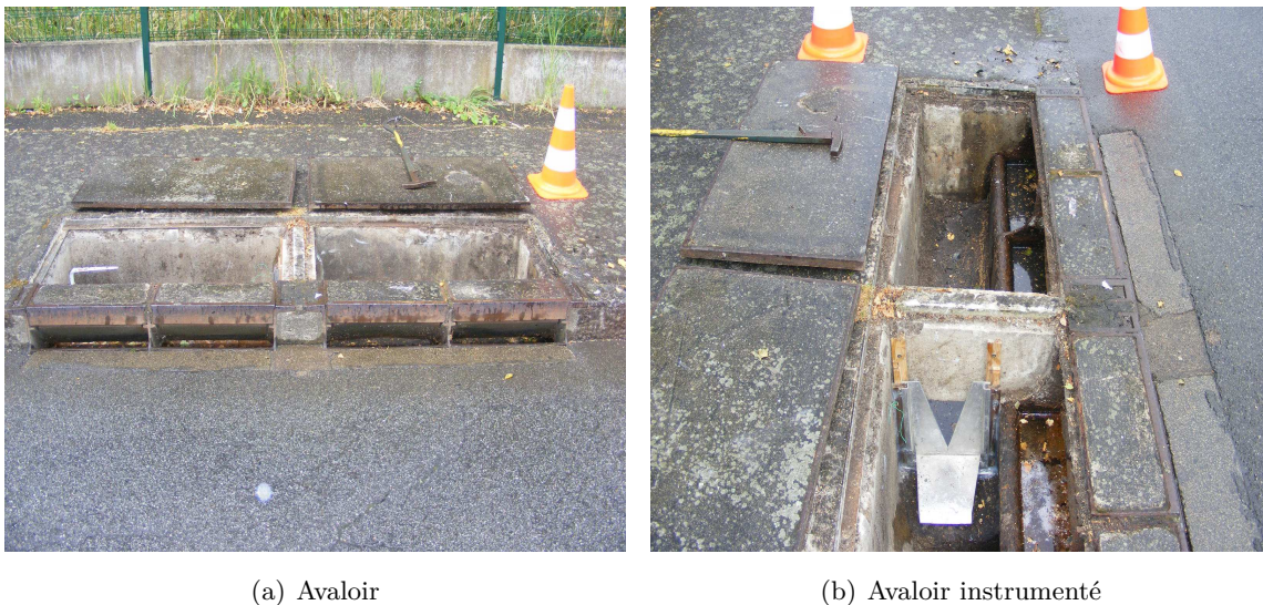
FIGURE 2.13 – Instrumentation d'un des avaloirs collecteurs des eaux de ruissellement de la rue de la Riveterie
