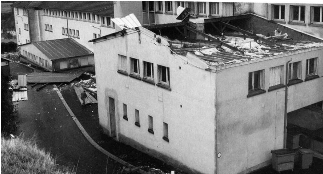
Photo 2 : La toiture arrachée du bâtiment de l'I.U.F.M. d'Aurillac (source : Conseil Régional d'Auvergne)
