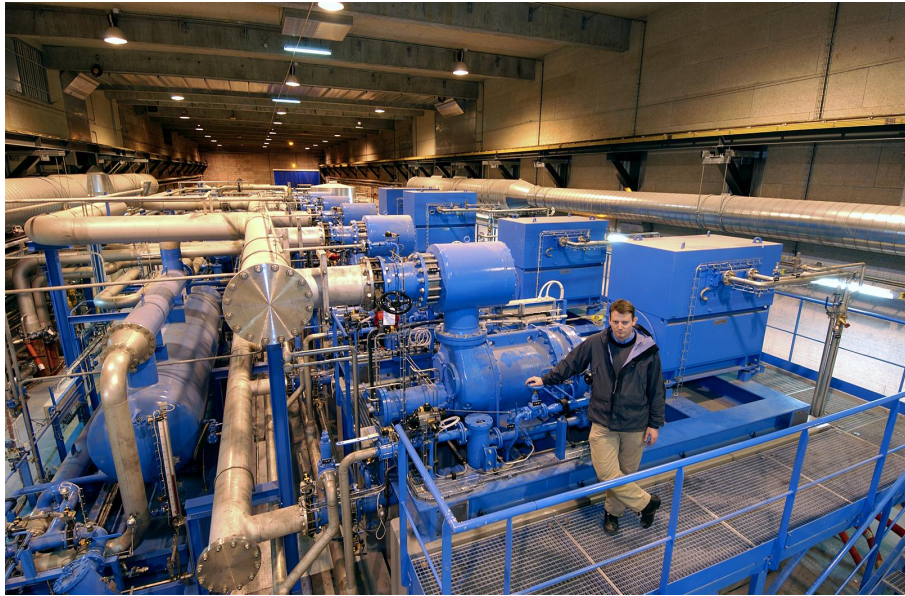
FIGURE 4.17 – Station de compression chaude pour le LHC
