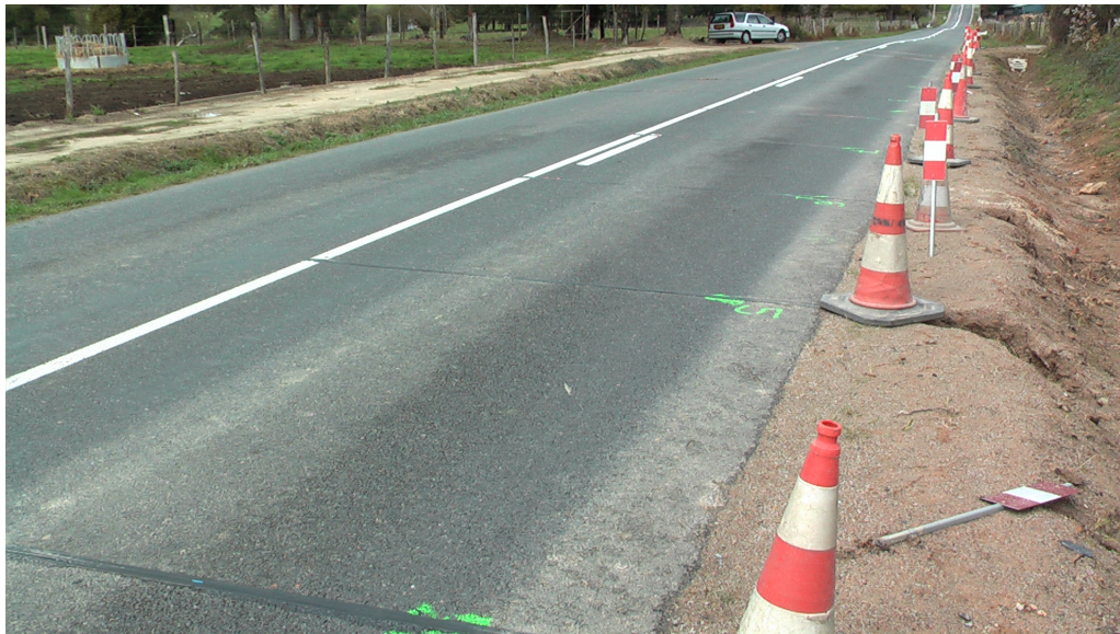
FIGURE E.6 – Visualisation d'une partie des capteurs résistifs et du remblayage sur l'accotement.
