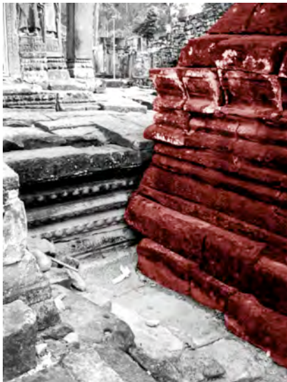
Ph. 244 : Connexion entre le soubassement de la “bibliothèque” BY.53 et le soubassement de BY.24
