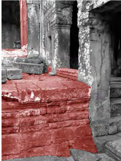
Ph. 217 : Connexion entre la terrasse se développant à l'Est de BY.39 et la galerie BY.23-24
