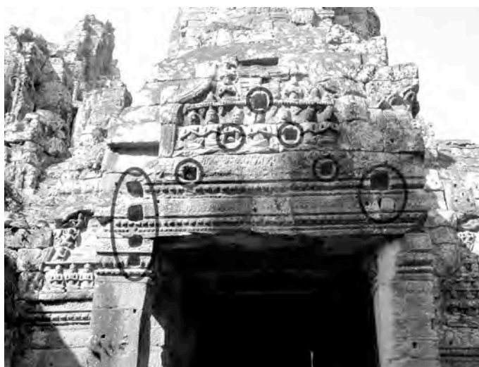
Ph. 126 : Empreintes de la charpente de l'appentis en bois greffé au porche de l'avant-corps oriental de la tour BY.48
