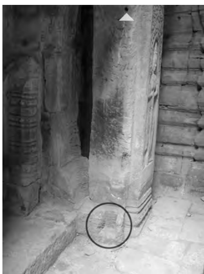
Ph. 138 : Pilier et pilastre Nord du porche oriental de la tour BY.43
