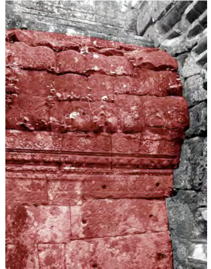
Ph. 186 : Extrados du bas-côté Nord de l'avant-corps occidental de la tour BY.22
