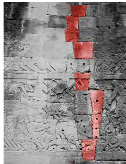
Ph. 15 : Exemple d'assises avec coins de forçage (en rouge) au mur de la galerie BY.64
