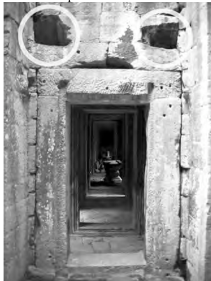
Ph. 29 : Exemple de pillage de crampons de linteau décoratif par l'intérieur
