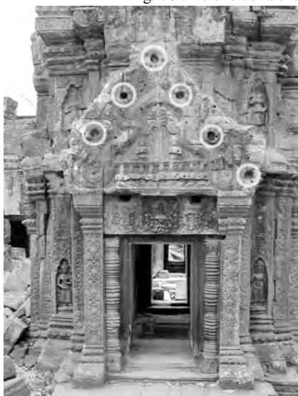
Ph. 119 : Exemple de traces d'appentis prévus originalement sur le fronton de l'entrée Sud de la tour TP.49 à Ta Prohm
