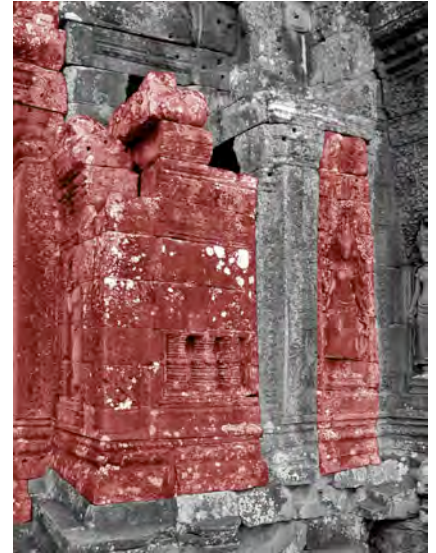
Ph. 198 : Blocage (en rouge) de la loggia Nord-Est de la tour BY.15
