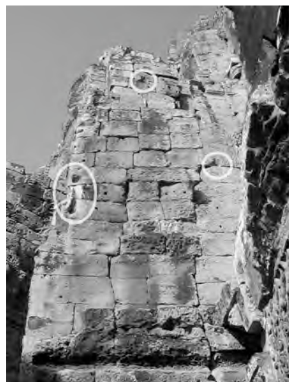
Ph. 75 : Face Est de la tour BY.11 présentant des logements de crampons
