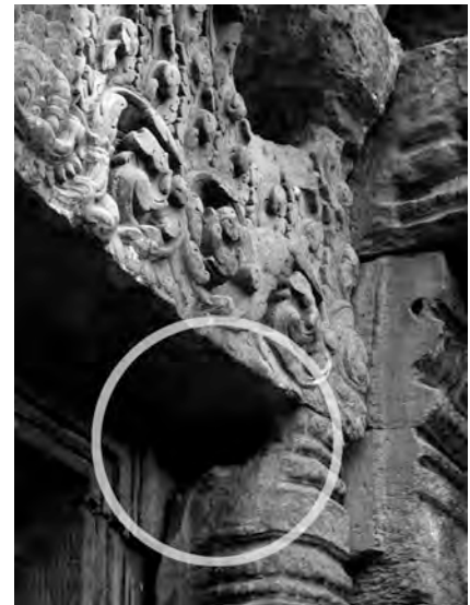
Ph. 30 : Exemple de pillage de crampons de tête de colonnette
