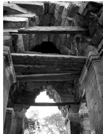
Ph. 13 : Vestiges des plafonds de la tour occidentale de Banteay Torp
