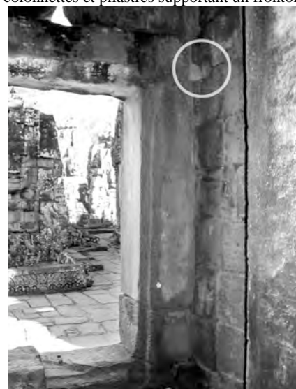
Ph. 19 : Logements du système mixte de fixation des tourillons supérieurs des deux vantaux en bois
