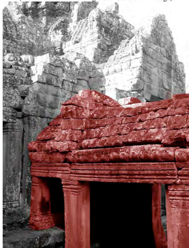
Ph. 180 : Connexion entre la galerie BY.31-32 (en rouge) et l'avant-corps Sud de la tour BY.31 (vue de la courette de l'angle Nord-Ouest du 2 ème étage)
