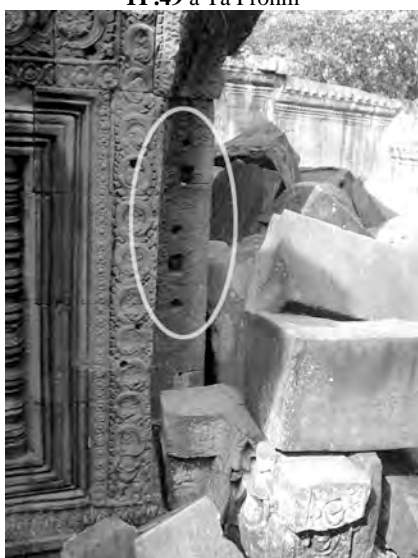
Ph. 121 : Exemple de traces d'appentis sur le pilastre Sud de l'entrée Est de la tour TP.70 à Ta Prohm
