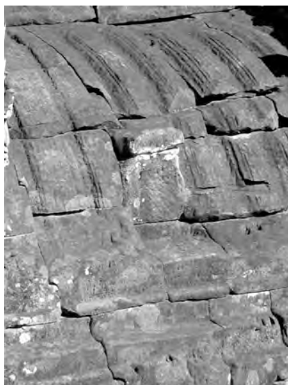
Ph. 165 : Détail de l'amorce du faîtage de porche intérieur de la galerie BY.22-23
