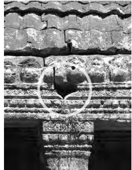
Ph. 27 : Exemple de pillage de crampon entre architrave
