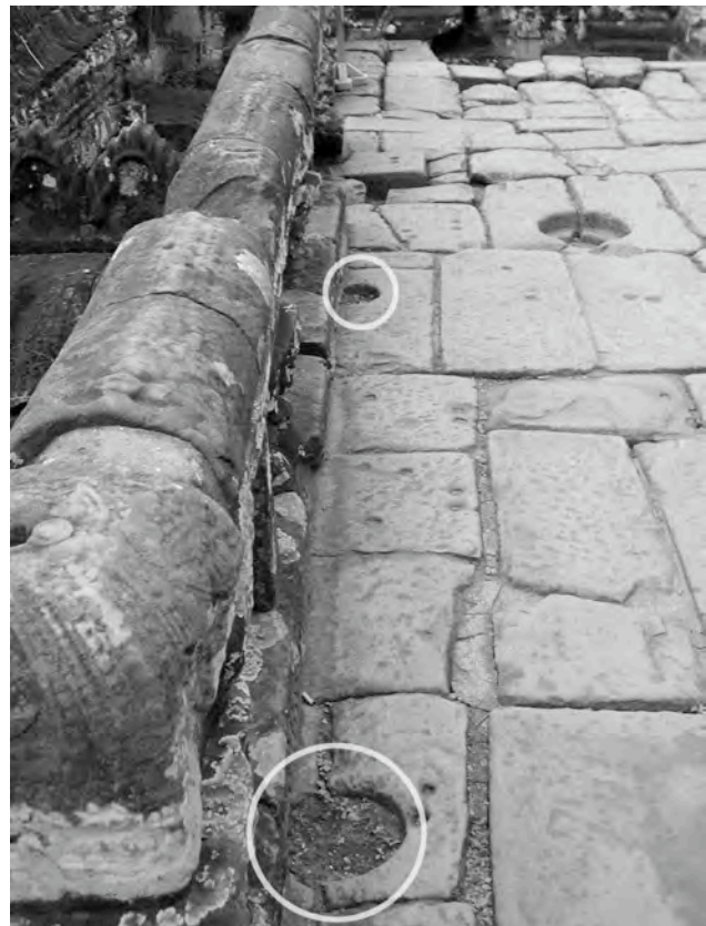
Ph. 146 : Alignement de logements d'une balustrade sur le dallage se développant au Nord de la tour BY.15
