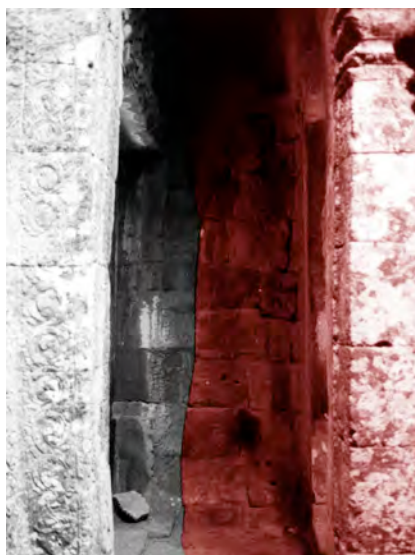
Ph. 150 : Exemple de " coup de sabre "dans un mur de la galerie du deuxième étage
