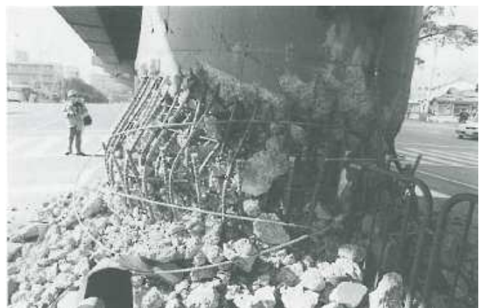
Figure 1-5 : Ruine de pile par rupture de soudure des aciers longitudinaux (Kobe, 1995), d’après [Priestley et al., 1996].
