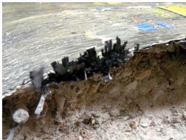
Figure 3-36 : Fibres libres suite à l'écrasement des ancrages – autopsie de PCLA1.
