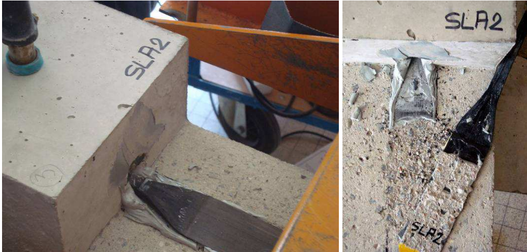
Figure A2- 9 : Glissements successifs de l'ancrage pour le bloc SLA2, puis finalement extraction du système de renforcement.
