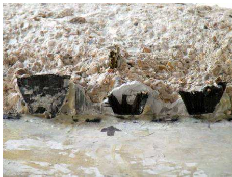
Figure 3-55 : Rupture des lamelles ancrées au niveau de la zone de transmission des efforts entre la partie courante et la lamelle ancrée.
