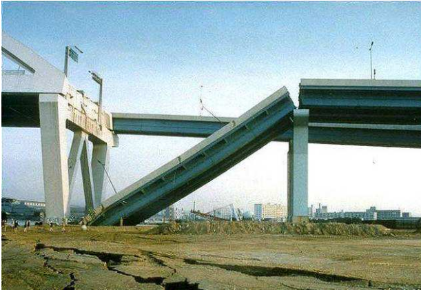
Figure 1-1 : Echappement du tablier (Kobe, 1995) (d'après [NISEE]).
