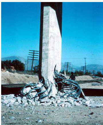
Figure 1-4 : Rupture par manque de confinement (San Fernando, 1971).
