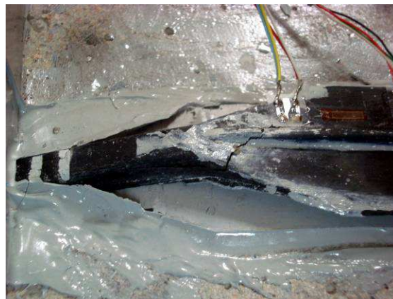
Figure 2-53 : Cylindre d'extrémité arraché de son trou de scellement (SLAa3).
