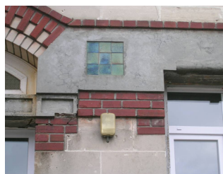
Doc 121 : détail de la façade de la mairie-école de Chevregny : assemblage de carreaux de faïence à dégradés de bleu et vert de façon géométrique (cubes) 818
