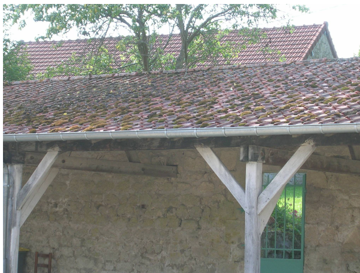
Doc 138 : préau de la commune de Vassogne recouvert de Pannes. On notera la finesse de la charpente, notamment des poteaux 859
