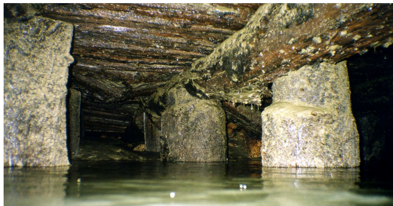
Figure I-9. Exemple de détérioration du platelage en hêtre sous les quais du Grand Port Maritime de Rouen
