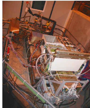
FIG. 5.5 – Photographie du toit du cryostat.
