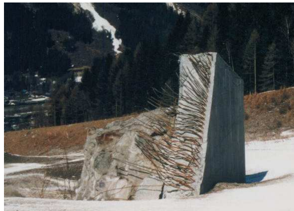
Photo 1.5: - Dent déflectrice endommagée - Tacconnaz (Haute-Savoie) (photo C. Ancy)
