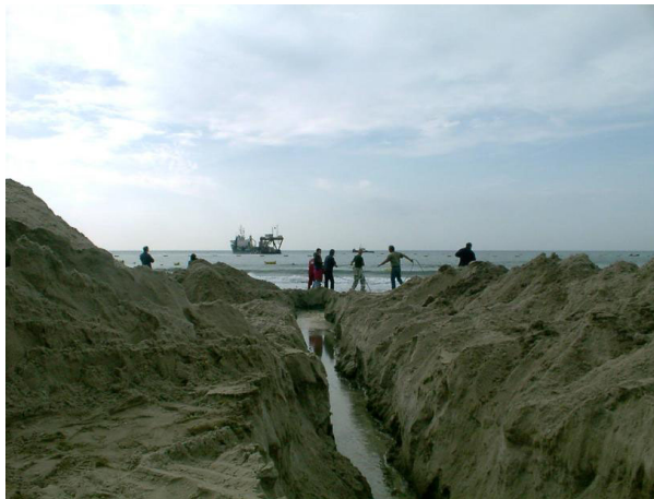
Figure C-11 : photographie montrant l'arrivée du câble électro-optique, reliant le détecteur à la côte, sur la plage des sablettes à La Seyne-sur-Mer (10 oct. 2001).
