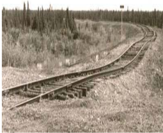
Fig. 2.6 : Affaissement d'une voie ferrée en forêt boréale, au Manitoba (Canada), région affectée par le pergélisol.
