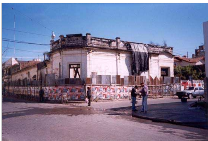
Vue 7 - Casa Macedonio Graz. Maison privée classée en attente de restauration. Seule la façade est conservée (Jujuy)
