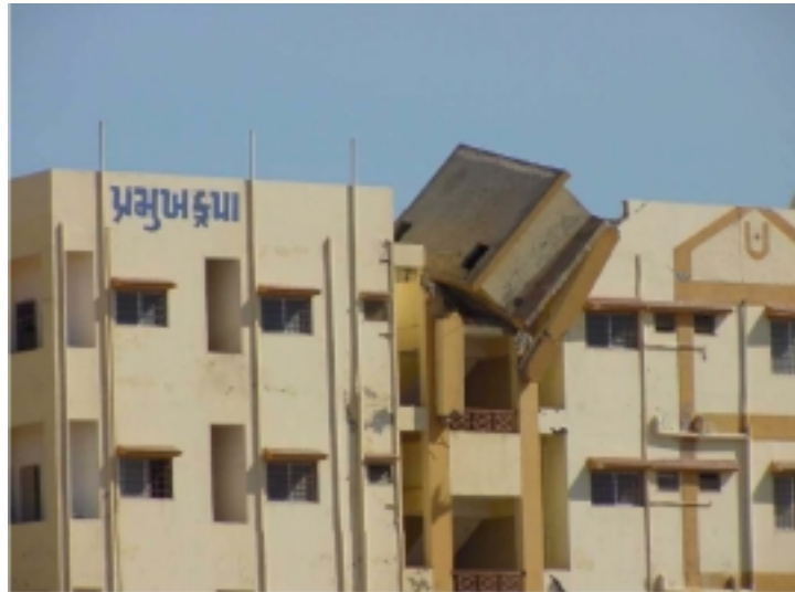
Figure 4.16 Effondrement du réservoir d'eau, situé au dernier étage, phénomène constaté sur une large échelle suite au séisme de Bhuj (source : EERI, 2001).
