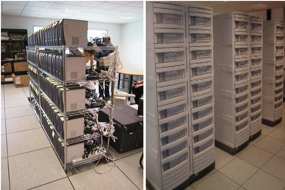
Figure 6.4 (A gauche) Grappe de PCs du projet iCluster (HP, INRIA, ID-IMAG) composée de 226 mono-processeurs Pentium III à 733 MHz avec 256 Mo de mémoire, inter-connectés via un réseau de 100 Mbit/s. (A droite) Grappe du projet iCluster2 composée de 104 bi-processeurs Itanium-2, 64 bits à 900 MHz avec 3 Go de mémoire, inter-connectés par un réseau Myrinet.
