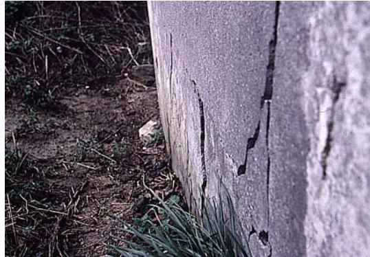
Figure 2 : fissuration sévère d'un massif de fondation d'après [LAR-1999]
