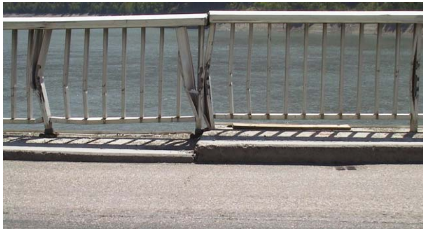
Figure 3 : exhaussement des bordures de crête sur le barrage du Chambon
