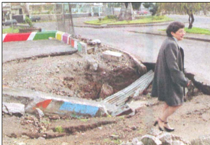
Photo 48 : Affaissement de chaussée construite sur un cours d'eau remblayé Quartier La Vicentina (Quotidien El Comercio 28/01/2001).
