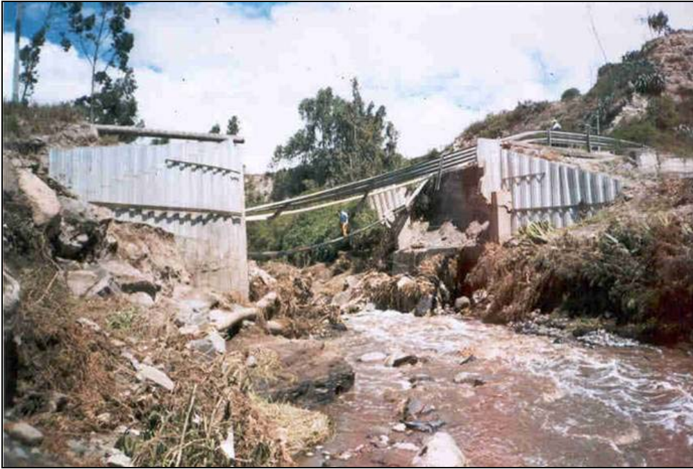
Photo 52 : Destruction du pont d'accès au lotissement La Pampa au nord de Quito ( Pomasquí ) (Cliché : F. Demoraes – Décembre 2001).
