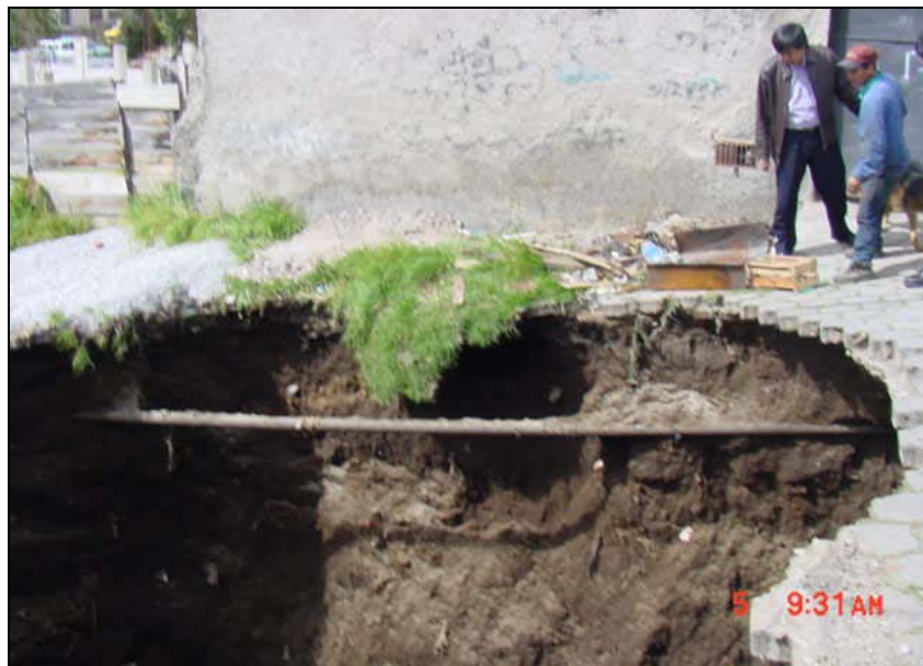
Photo 47 : Affaissement d'une chaussée construite sur un cours d'eau remblayé, rue Colonche, Quartier Mena II (Cliché : Seguridad Ciudadana - MDMQ – 2001).
