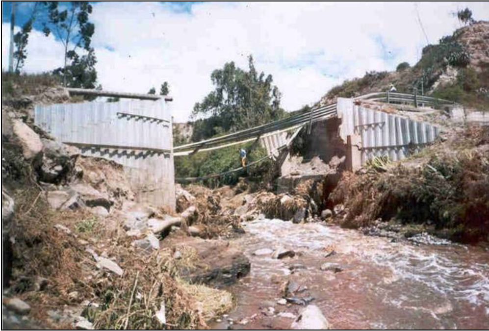
Photo 52 : Destruction du pont d'accès au lotissement La Pampa au nord de Quito ( Pomasquí ) (Cliché : F. Demoraes – Décembre 2001).
