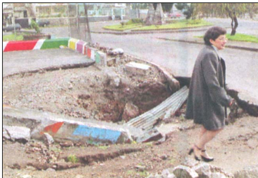
Photo 48 : Affaissement de chaussée construite sur un cours d'eau remblayé Quartier La Vicentina (Quotidien El Comercio 28/01/2001).
