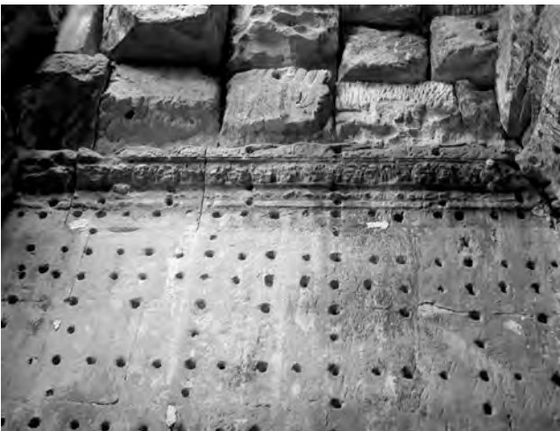
Ph. 955 : Aspect intérieur des murs de l'avant-corps occidental du sanctuaire central du Preah Khan d'Angkor
