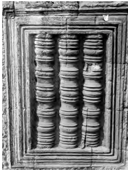
Ph. 699 : Fausse-fenêtre à hauts balustres à Ta Prohm présentant des traces d'enduit
