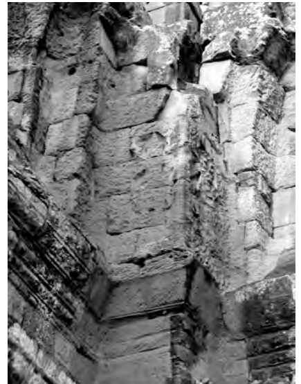
Ph. 962 : Devatâ martelé au premier faux-étage du sanctuaire central de Banteay Kdei
