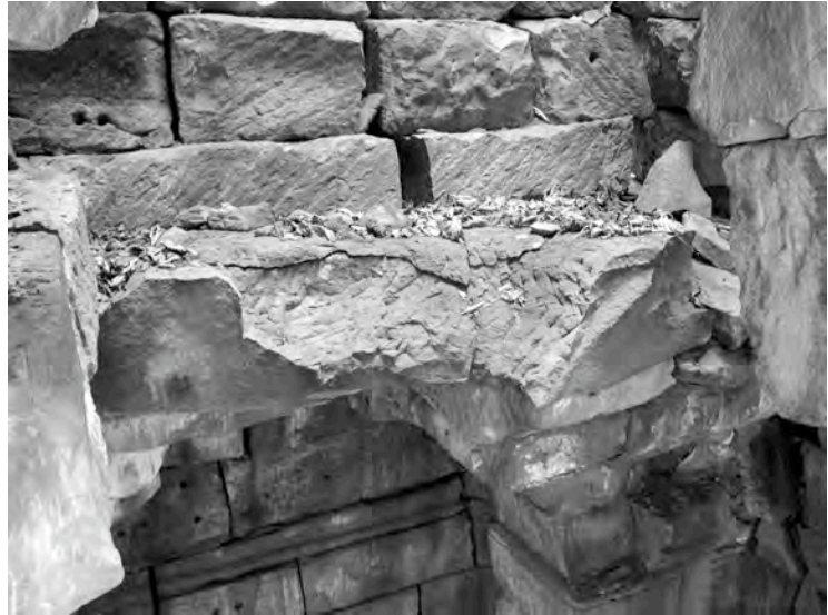
Ph. 897 : Vue intérieure de la superstructure partiellement ruinée du pavillon d'angle Sud-Est BC.24 de la première enceinte de Banteay Chmar
