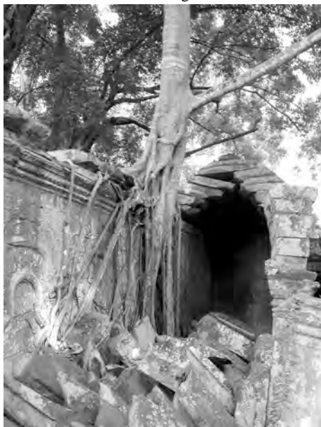
Ph. 110 : Vestiges de la nef centrale du tronçon de la galerie TP.88 de la troisième enceinte de Ta Prohm
