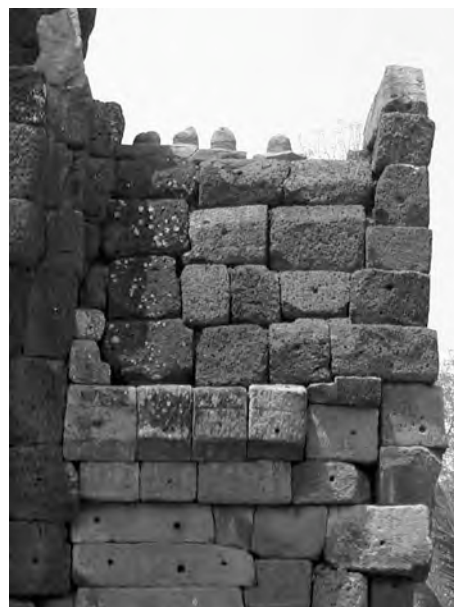
Ph. 648 : Faîtage de l’avant-corps de la chapelle de l’hôpital de Kuti Rishi Ban Nong Bua Lai (Thaïlande)
