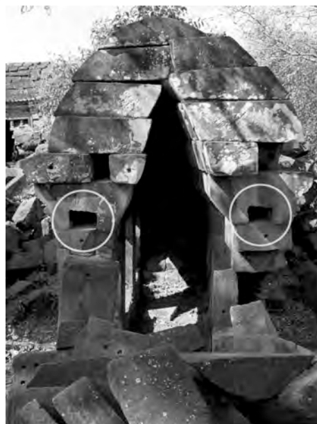
Ph. 41 : Logment de poutres en doublure à la première galerie-enceinte de Chau Srei Vibol
