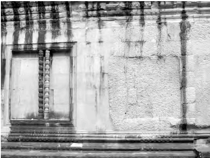
Ph. 681 : Fausse-fenêtre non achevée à Angkor Vat
