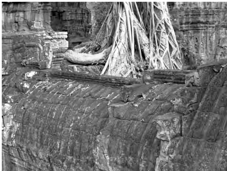
Ph. 624 : Cordons d'embarrures à la première galerie-enceinte de Ta Prohm
