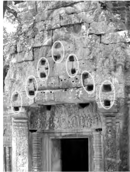
Ph. 782 : Fronton Est de la tour TP.65 présentant les traces d'une charpente à pannes doublées à Ta Prohm
