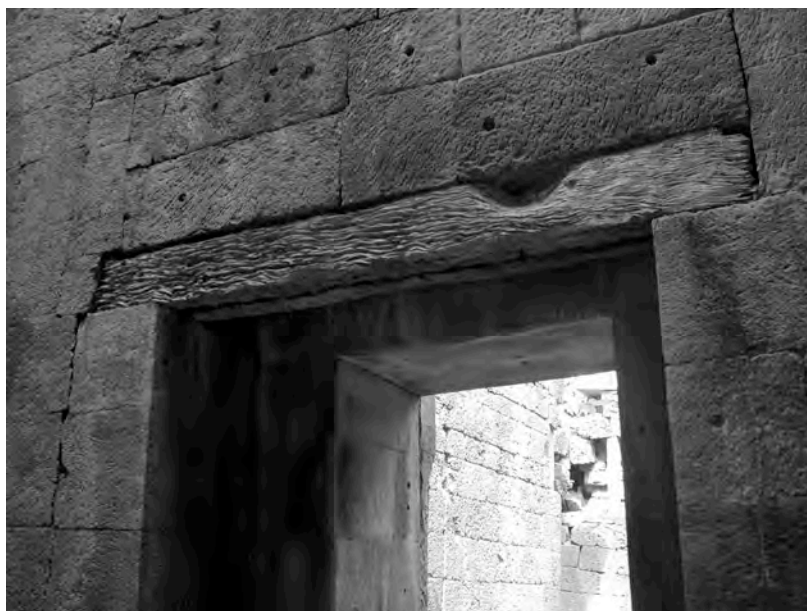
Ph. 40 : Poutre de soutien en bois faisant office de linteau au Kleang Nord à Angkor Thom
