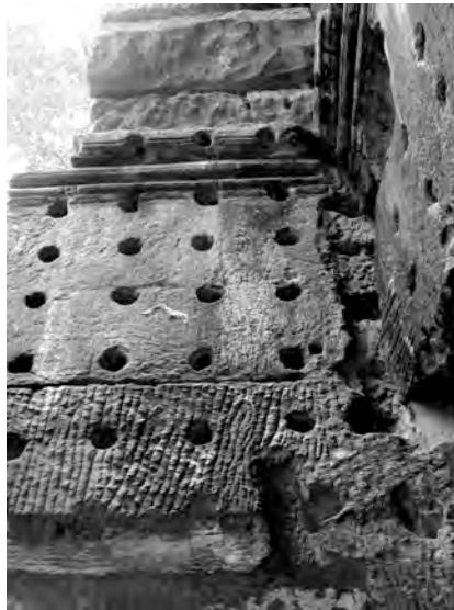
Ph. 949 : Détail de l'aspect intérieur de l'avant-corps Nord du sanctuaire central de Ta Prohm
