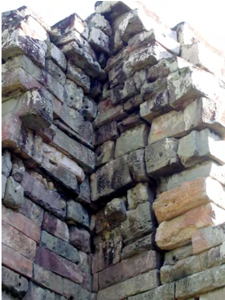
Ph. 820 : Intrados de la cheminée du sanctuaire de Ta Prohm Kel
