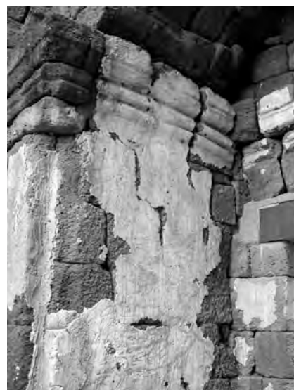
Ph. 941 : Vestige d'enduit dans le pavillon axial Nord MS.15 de la première enceinte
