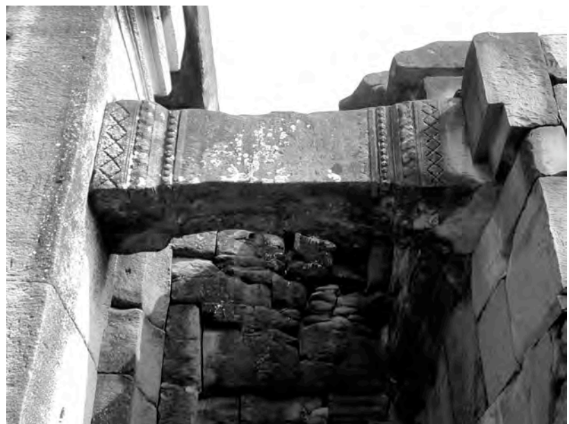
Ph. 792 : Détail d'un étrésillon au pavillon axial Sud de la deuxième enceinte de Phimai
