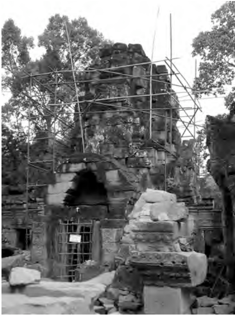
Ph. 417 : Pavillon d'entrée Est TS.5 de la première enceinte de Ta Som (vue de la face occidentale avant restauration)
