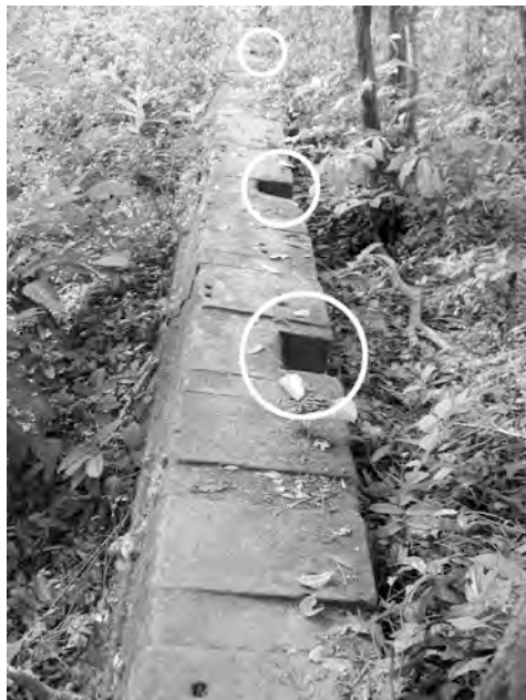
Ph. 873 : Amorce du mur de la galerie Nord-Est de la troisième enceinte de Beng Mealea présentant des réservations pour des piliers en bois
