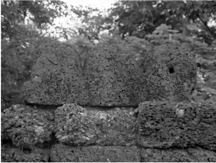
Ph. 643 : Faîtage de type 4 en latérite de la 1 ère enceinte de Prasat Prei
