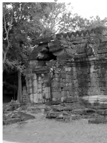
Ph. 54 : Pavillon d'angle Nord-Ouest de la première enceinte de Ta Som présentant des fausses portes côté extérieur
