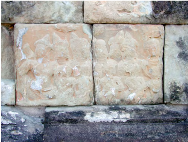
Ph. 33 : Exemple de la détérioration du grès des bas-reliefs du Bakong
