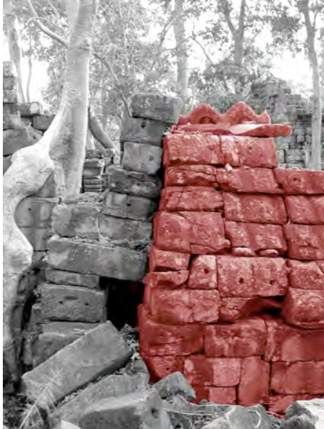
Ph. 616 : Exemple d'analyse structurelle facilitée par la ruine partielle d'édifices au complexe oriental de Banteay Chmar
