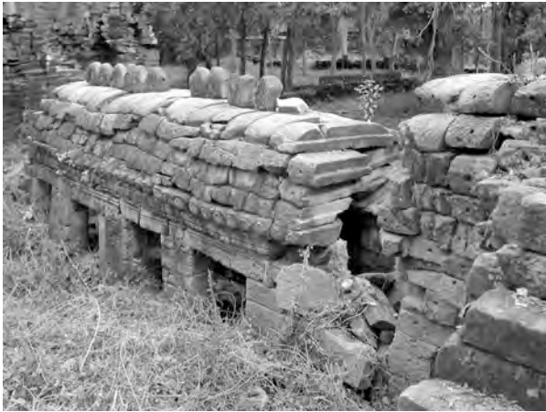
Ph. 464 : Tronçon de galerie Sud BC.129 de l'enceinte du second complexe occidental
