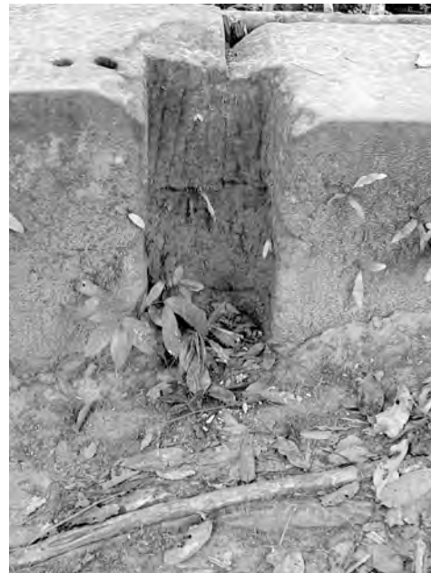
Ph. 874 : Détail d'une réservation dans les trois premières assises du mur de la galerie Nord-Est de la troisième enceinte de Beng Mealea
