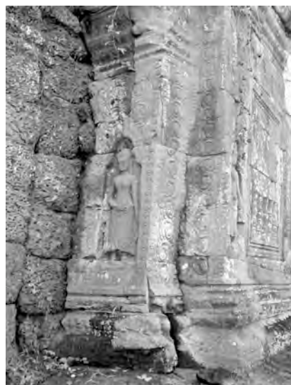
Ph. 280 : Connexion entre le mur de l'enceinte de domaine et le pavillon d'entrée latérale Nord PK.173 de la porte orientale
