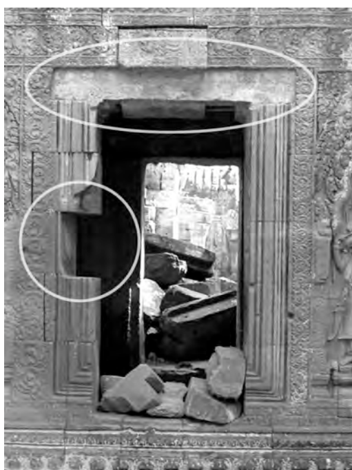
Ph. 621 : Exemple d'un piédroit d'une fausse-fenêtre transformée en porte à la première enceinte de Ta Prohm présentant une lacune
