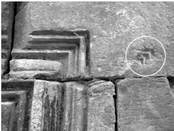
Ph. 702 : Détail de l'ébauche d'une première fausse-fenêtre à la face Nord de l'édifice TP.48 à Ta Prohm
