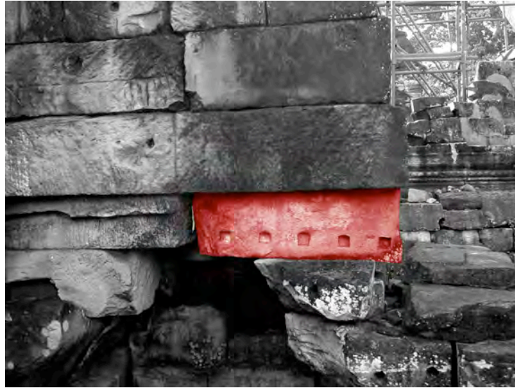
Ph. 803 : Exemple de bloc en réemploi dans la cheminée de la tour PK.30 du Preah Khan d'Angkor
