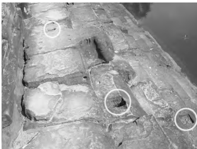
Ph. 865 : Mortaises de part et d'autre de la vasque de l'édifice du bassin secondaire Ouest
