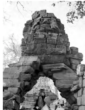
Ph. 477 : Vestiges de la superstructure du pavillon d'angle Sud-Ouest BC.70 de l'enceinte du complexe occidental
