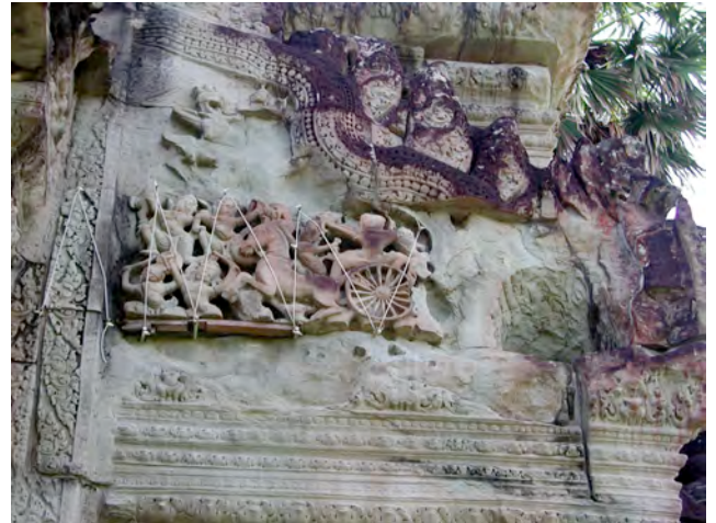
Ph. 34 : Exemple de la détérioration du grès d'Angkor Vat (un programme de conservation du décor sur grès de ce monument et actuellement mené par l'équipe allemande GACP)
