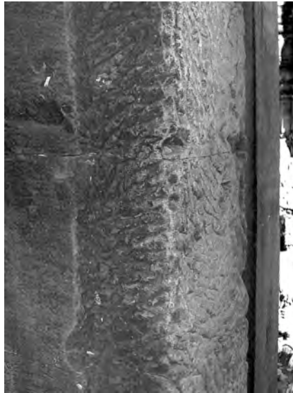
Ph. 754 : Piédroit Nord de l'avant-corps oriental de la tour BY.15 du troisième étage du Bayon
