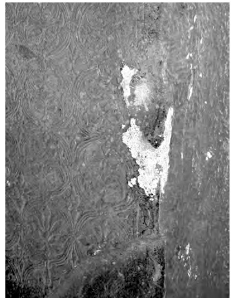
Ph. 726 : Vestige d'enduit sur un des tableaux de la porte Nord de la tour TP.49 de Ta Prohm
