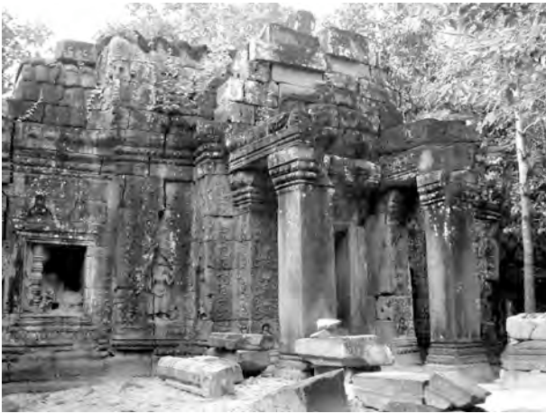
Ph. 413 : Pavillon d'entrée Est TS.22 de la seconde enceinte de Ta Som (vue de l'angle Sud-Est)
