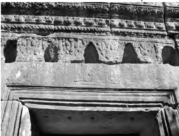
Ph. 66 : Trous d'aération au-dessus de la fenêtre du mur Sud de la “bibliothèque” Sud du cloître Nord du Preah Khan d'Angkor
