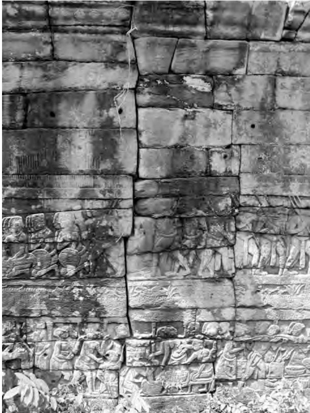
Ph. 38 : Exemple de “ coup de sabre ” au mur de la galerie de la troisième enceinte de Banteay Chmar
