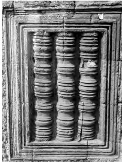
Ph. 699 : Fausse-fenêtre à hauts balustres à Ta Prohm présentant des traces d'enduit
