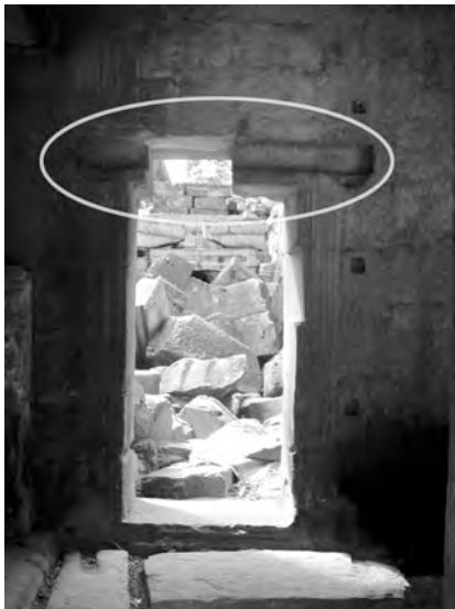
Ph. 619 : Exemple de logement de poutre intérieur d'une porte ouverte dans un mur à la troisième enceinte de Ta Prohm
