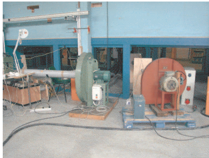
FIG. 3.4 – Vue des ventilateurs et de l'extérieur de la veine d'essai L2.
