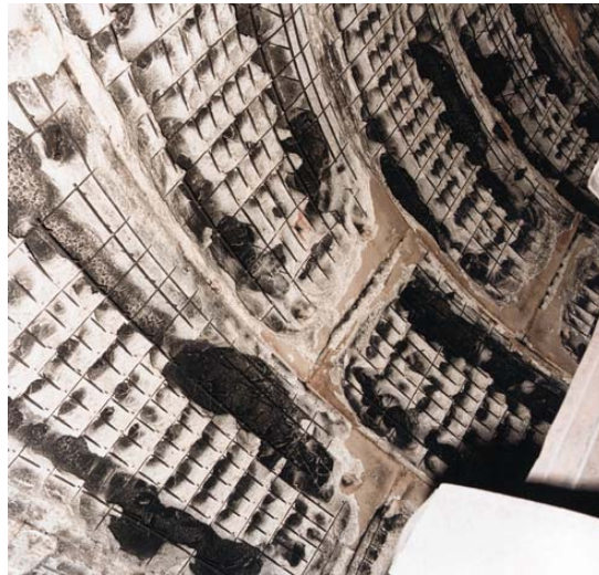
Figure I. 2 : Dégâts observés après l'incendie dans le tunnel sous la Manche
