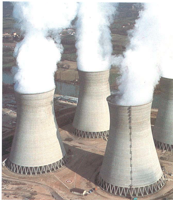
FIG. 6.1 – Les tours aéroréfrigérantes de la centrale du Bugey
