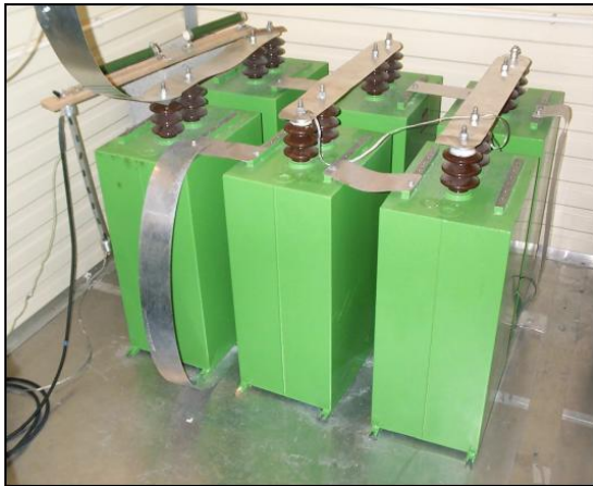
Figure II-4 : Condensateurs de puissance
