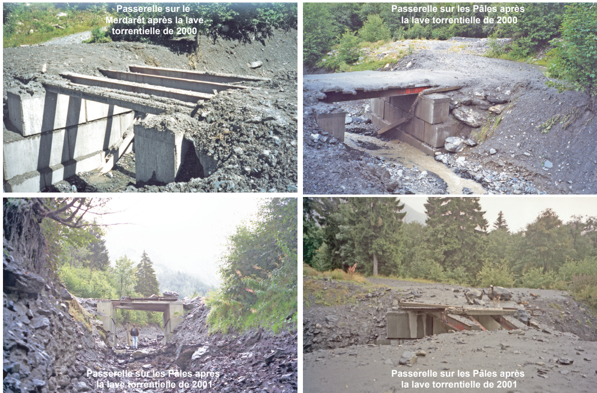
Figure 4-11 Etat des passerelles enjambants le Merdarêt et les Pâles après les laves torrentielles de 2000 (essentiellement dans le Merdarêt) et de 2001 (essentiellement dans les Pâles) (Clichés S.V.C.)
