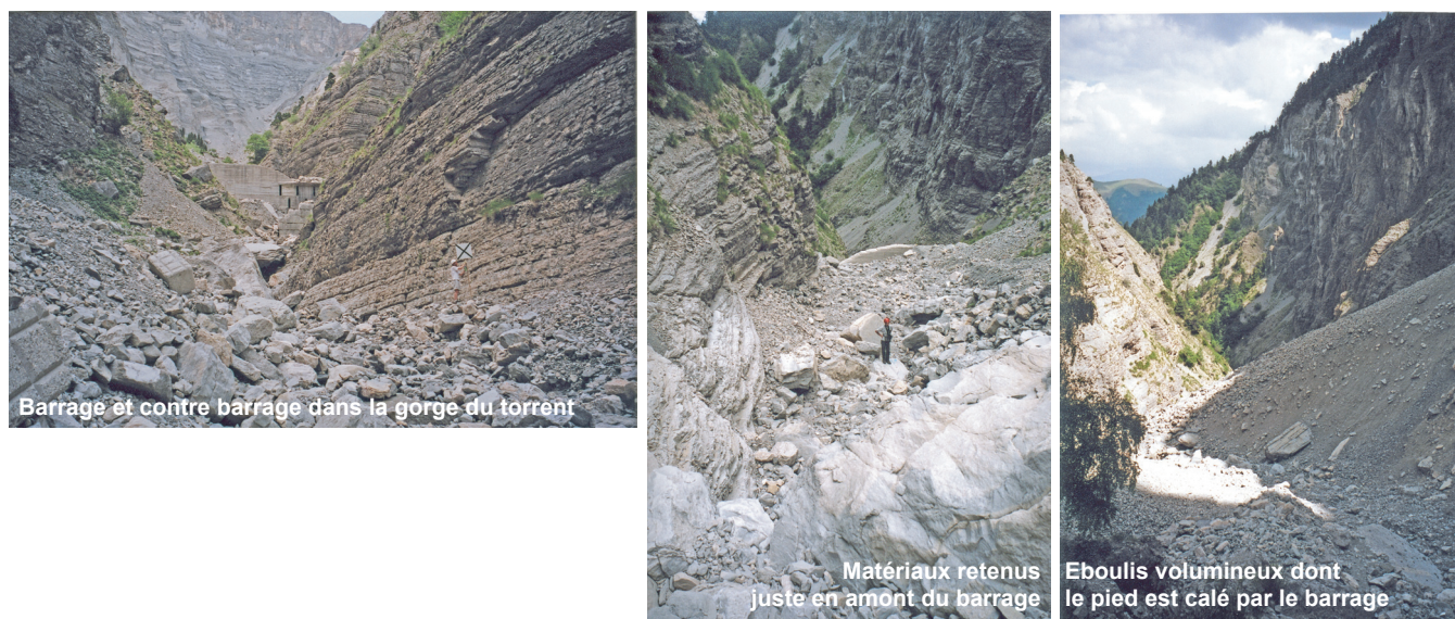
Figure 4-8 Barrage et contre-barrage de correction torrentielle dans la gorge du chenal des Arches. Le mauvais état et les blocs en bétons disloqués du contre-barrage sont bien visibles sur la photographie de gauche. Si le barrage venait à céder, il libérerait de grandes quantités de matériaux comme le montrent les photographies de droite (Clichés S.V.C.)
