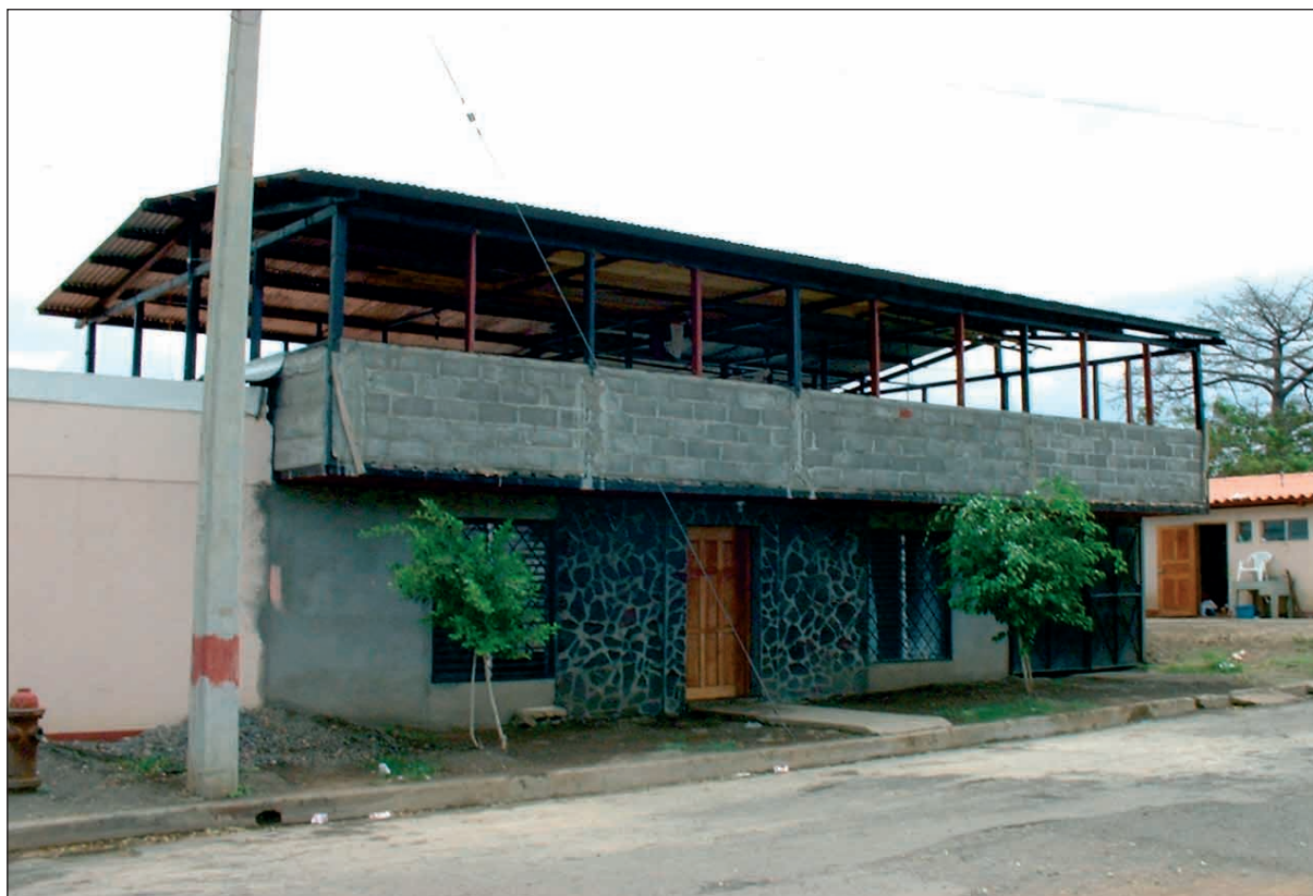
Photographie 14 - Immeuble construit dans le cadre d'un programme de l'Union européenne selon des normes parasismiques dans le quartier de San Sebastián en 2000. Un an plus tard, le propriétaire de l'immeuble avait déjà entrepris en toute illégalité des travaux d'agrandissement, rendant son logement dangereux en cas de séisme (Cliché: S. Hardy, 2001).
