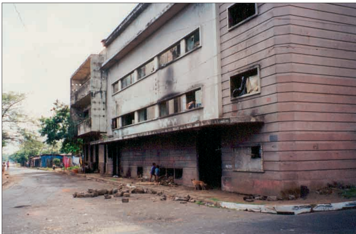
Photographie 21 - Un immeuble en béton resté debout après le tremblement de terre du 23 décembre 1972. Il a été réinvesti par les couches très pauvres de la population, qui souhaitent profiter non seulement de la situation centrale du lieu, mais aussi d'un toit en dur, gratuit, et de certains des services urbains dont bénéficiaient le centre colonial (réseau d'égout et pluvial). A l'arrière-plan, on trouve un établissement spontané qui s'est installé sur les parcelles nettoyées après 1972 (Cliché : S. Hardy, 1999)
