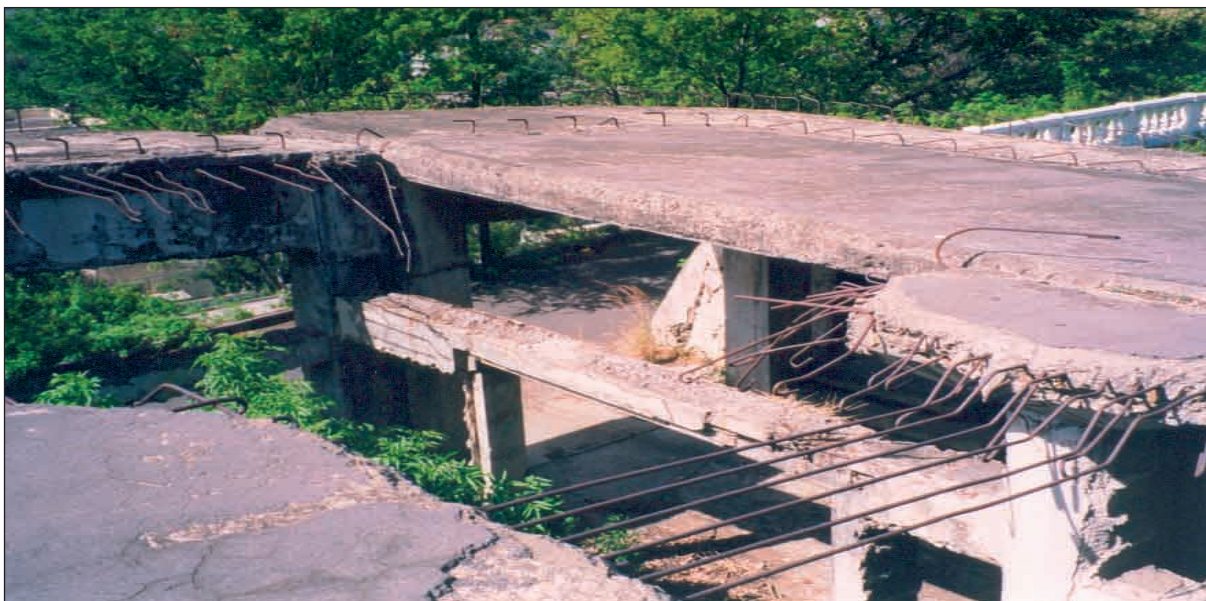
Photographie 4 - Les installations de la Garde nationale de Somoza, en dépit de leurs structures en béton armé, pour avoir été installées sur la ligne de faille Tiscapa, ne résistèrent pas au séisme du 23 décembre 1972 (Cliché : S. Hardy, 2000).
