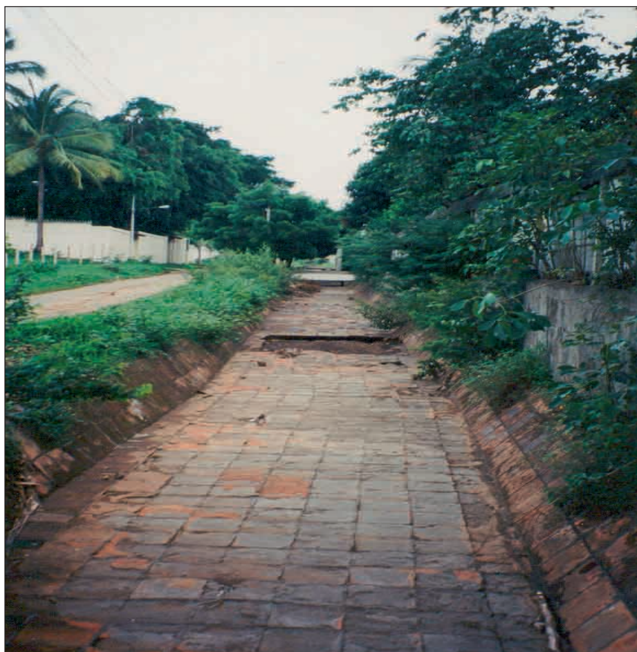
Photographie 1 - Aménagement pour l'évacuation des eaux de ruissellement dans le quartier résidentiel aisé de Las Colinas, destiné à protéger les riches propriétés encerclées de hauts murs (Cliché : S. Hardy, 2000).
