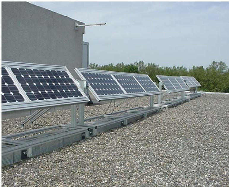
Figure 3.1. Vue d'ensemble du site d'étude situé sur un des toits terrasse du LAAS-CNRS.
