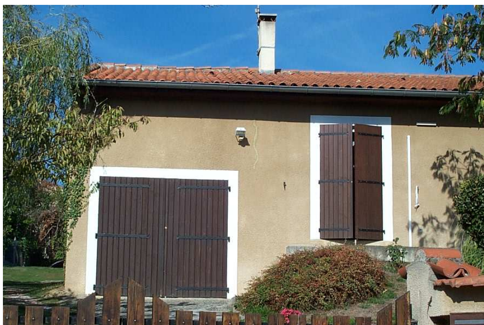
Figure 45 : « ... il y a des fissures extérieures qui suivent... »
