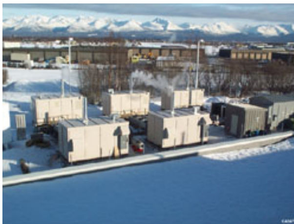
Figure 1.10 : Cinq systèmes de piles à combustible UTC (PureCell™ 200, 200 kW) en Alaska, USA [Utc].
