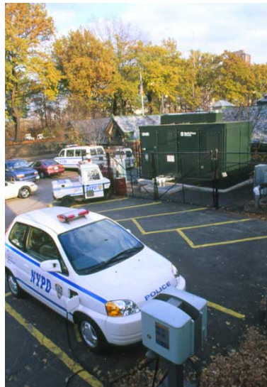
Figure 4 : Piles à combustible de UTC à Central Park New York [Kis03].
