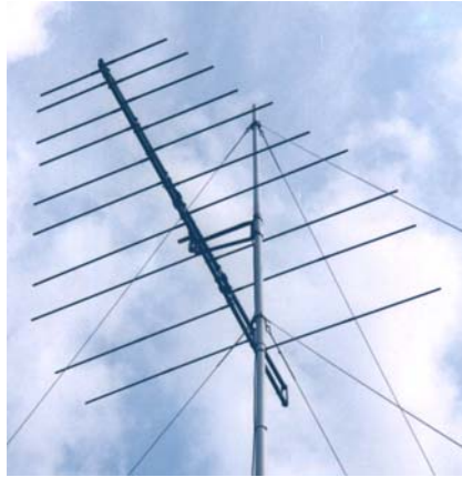
Figure 23 : Vue d'une antenne RACAL DANA RA943-900.
