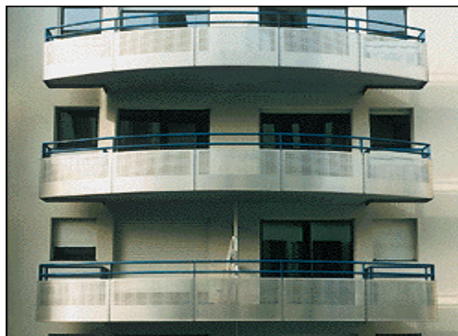
Figure 3-24 : Tôles perforées en inox pour remplissage de garde-corps
