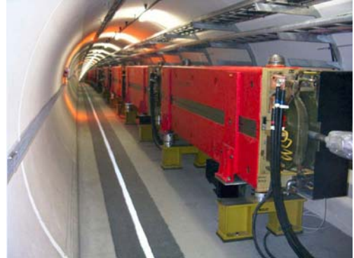
FIG. 1.7 – Vue d'une des 2 lignes d'injection : TI 2 qui amènera les protons du SPS vers le secteur 2 du LHC.
