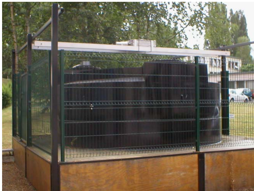
Figure B-22 : Photographie de la cuve test d'Orsay.
