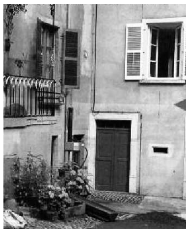
FIG. 2.4: Une laisse de crue sur un mur. Le sédiment transporté par la rivière a marqué la hauteur maximale atteinte lors de la crue (photo : SNNE).
