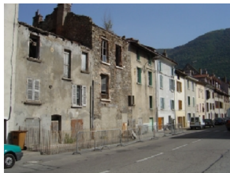
Photographie 65 : Vizille, habitat dégradé rue Jean Jaurès.
