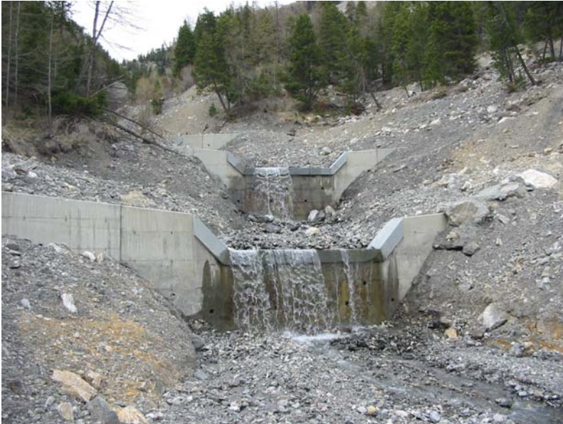
Id 63 n° 41+9 RTM n°42 Alt.: 1833.8 Mai 2004 Photo 95 Id 64 n° 41+10 RTM n°43 Alt.: 1841.906 (GPS) Mai 2004 Photo 95
