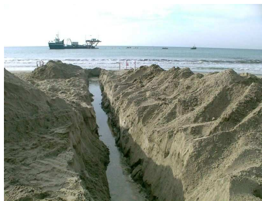
FIG. 2.14 – Photo prise lors de l'installation du câble électro-optique, sur la plage des sablettes, à La Seyne-sur-mer (oct 2001).
