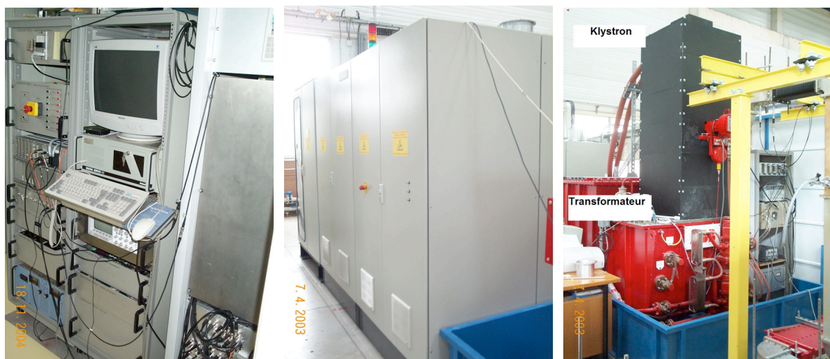
Figure (V.7) : Source de puissance. A gauche : système de contrôle/commande de la source de puissance. Au milieu : modulateur. A droite : klystron monté sur le transformateur de tension.
