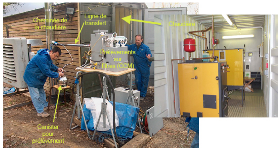
FIG. 3.1 – Site d'étude : la chaudière à bois de Flimwell.
