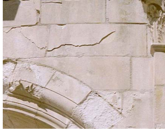
Figure I.18 : formation d'une plaque avec fissuration (château de Chambord)
