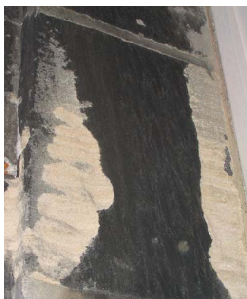
Figure I.8 : dépôt important de suies noires sur un encadrement de fenêtre en pierre de Sébastopol (Mello)
