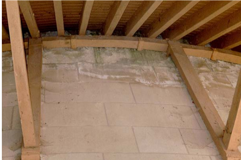
Figure I.10 : efflorescences blanches de sels provenant de la maçonnerie se développant sur un mur en tuffeau placé sous une charpente mal isolée des pluies (château de Chaumont)
