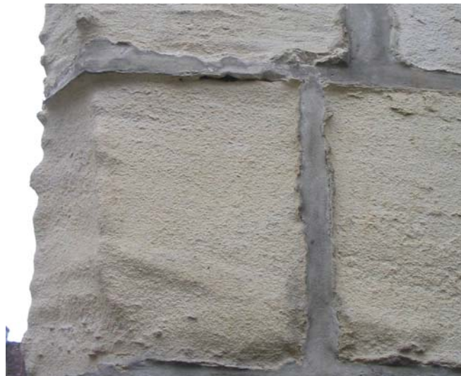
Figure I.28 : incompatibilité entre la pierre de Sébastopol et un mortier de ciment provoquant une altération des pierres en désagrégation sableuse (Mello)
