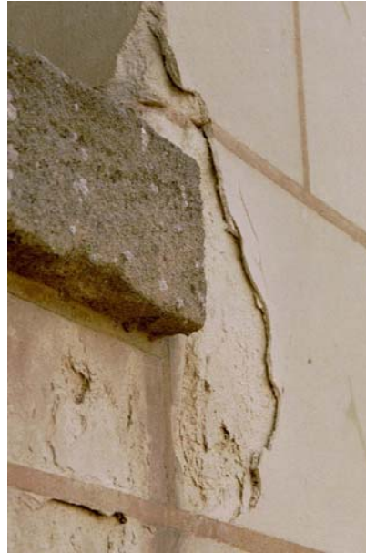
Figure I.14 : altération en plaques initiée sur un encadrement de fenêtres (château de Chambord)
