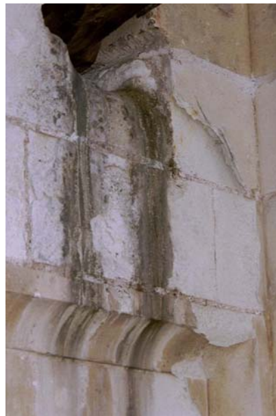
Figure I.16 : altération en plaques initiée par un apport d'eau particulier (château de Chaumont)
