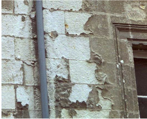
Figure I.4 : croûtes sulfatées en forme de cloques sur un mur en tuffeau (Nantes)
