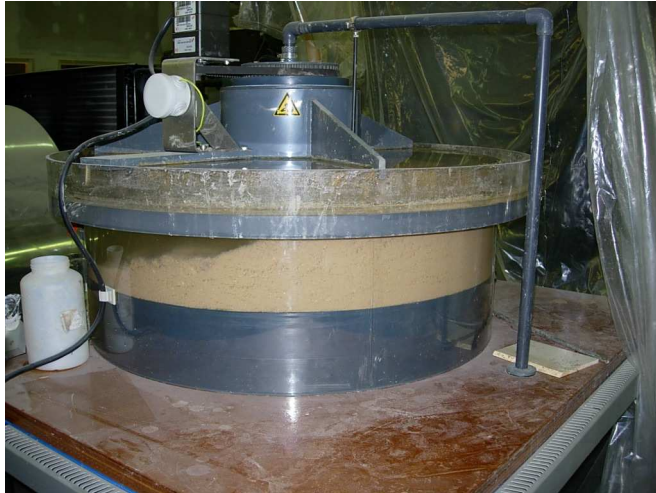
Figure 3.22 : Grande quantité de boues dans le clarificateur.
